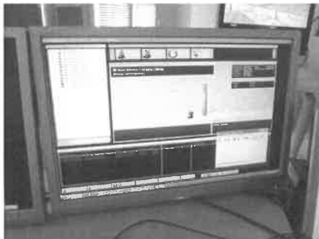
Matériel lié à un Système de Gestion Technique Centralisée (Toulouse – mais aussi Grenoble)
