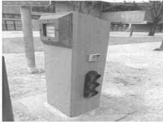
Adaptation du mobilier de contrôle d'accès à un contexte urbain sensible (Grenoble)
