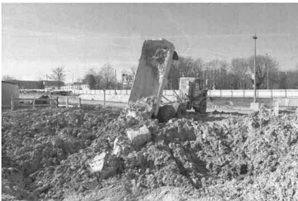
Camion de chantier vidant les déblais dans une fosse - site de la future gare de Noisy-Champs - Crédit : SGP
