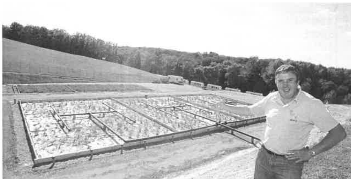
La station d'épuration naturelle du Talouch s'étend sur deux étages. Au total, environ 7 000 roseaux servent d'écume filtrant les eaux usées. PHOTO PUBLISCOPE MÉTROPOLITAIN / Crédits: Bobo - Société Presse
