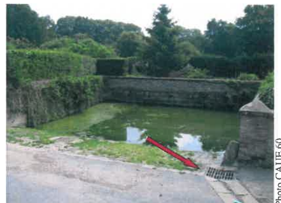
Arrivée d'eau sans traitement préalable
